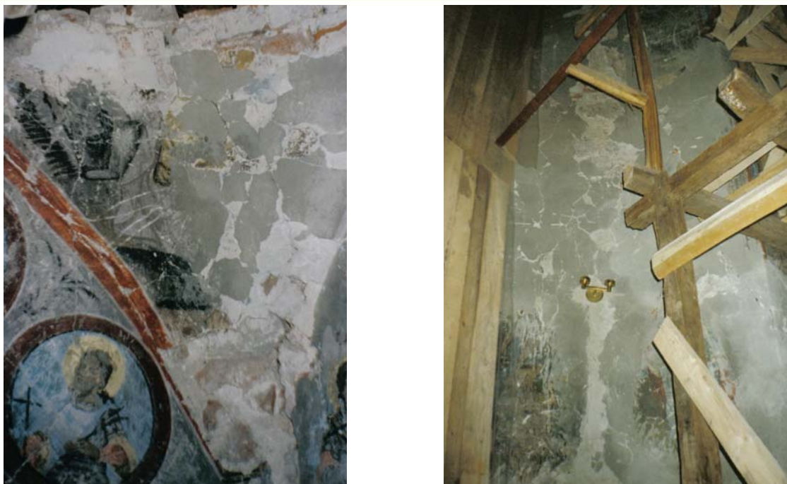
Fig. 16, 17. Aspecte din interiorul bisericii, cu evidențierea stării e conservare a picturii rămase la poziție. ( Răchitoasa, Bacău, 1998)
